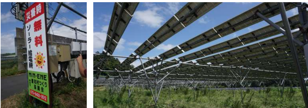
市民能源千葉一號機實踐「農電共生」形式的成功，以及用公開集資的方式獲得市民的支持，此案場設有災害時的電力供應機制，讓市民免費使用。
